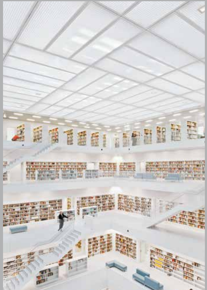
Deckenroste in einer Stadtbibliothek
